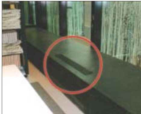
Van de klimaatapparatuur is uiteindelijk alleen het uitblaasrooster zichtbaar.
