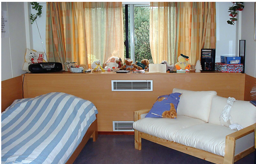
Slaapkamer met ingebouwde ventilatorconvector
